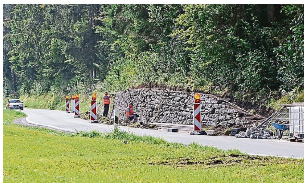
Eine Stützmauer an der Staatsstraße 2072 zwischen Wegscheid und Lenggries ist in so schlechtem Zustand, dass sie aktuell saniert werden muss. FOTO: ARNDT PROHL
