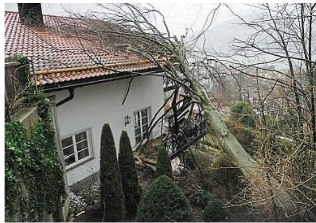
Erheblicher Schaden: An der Neureuthstraße in Tegernsee stürzte ein Baum auf ein Hausdach.
