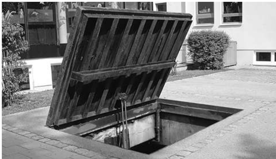
Der geöffnete Hackschnitzelbunker der Heizanlage in Otterfing
