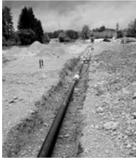
Bei der Verlegung ist die Überdeckung der Leitungen gering. Später, nach dem Bau der Straße beträgt sie 0,8m - 1m.
