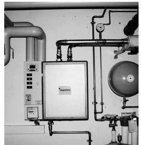
Übergabestation von Primär- zu Sekundärseite
