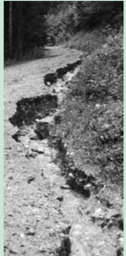
Enorme Schäden in Höhe von ca. 30.000 € hat das Hagelunwetter am 5. Juli an der Forststraße „Orterer Almweg“ in der Gemeinde Kochel am See angerichtet. Nachdem ca. 20 Durchlaßrohre wegen der abfließenden Wasser-, Eis- und Geschiebefracht verklebt waren, wurde der Wegekörper auf weiten Strecken entlang des bergseitigen Grabens metertief ausgespült. Die Reparaturarbeiten, die vom AELF Miesbach mit 80% der Nettobausumme gefördert werden, stehen kurz vor dem Abschluss.
